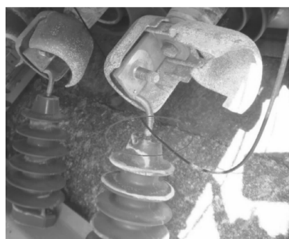
图11 带电显示器处的实际情况
