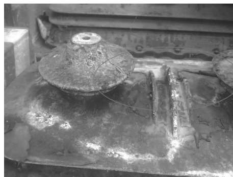
图9 母线排接触处的实际情况
